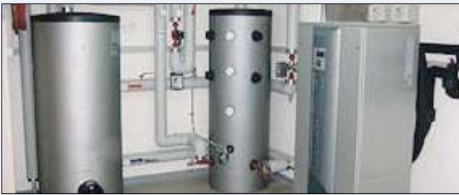
Pompe à chaleur/chauffage.
